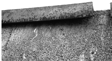
写真2 コンクリート製の壁と鉄製の屋根の隙間
