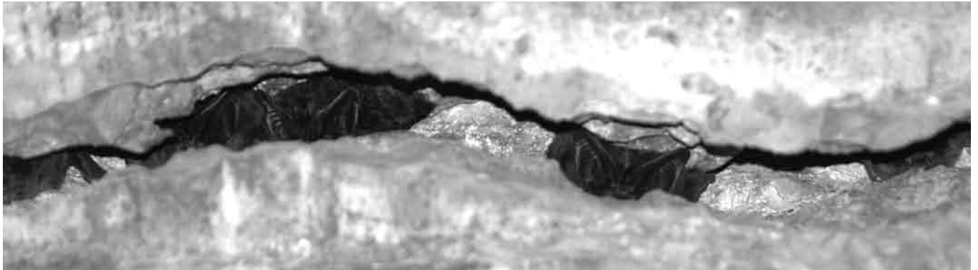
写真2 2006. 1. 10, No.5, 5個体 (コンクリートの亀裂)
