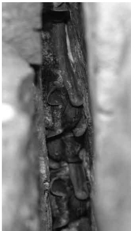
写真11 2006. 1. 12, No.2, 7個体中の 3個体 (露石の亀裂)
